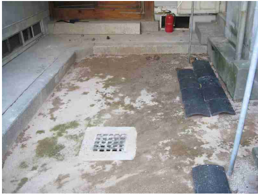
사진 29. 깨어진 배면 디딤돌과 기반석
