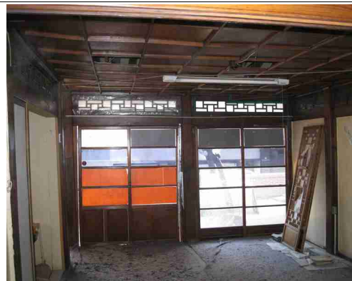
사진 16. 대청마루 현황(보수 전)
