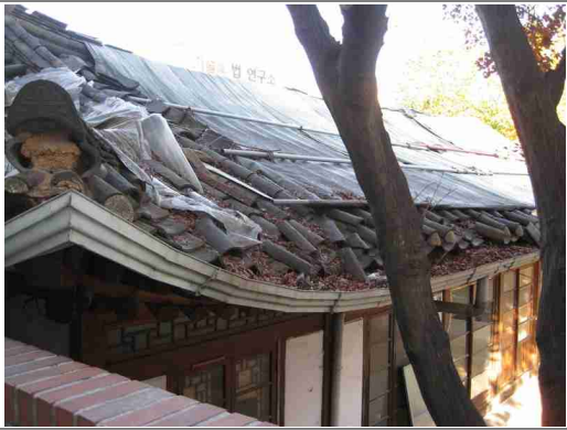
사진 11. 안채지붕 현황-1(보수 전)
