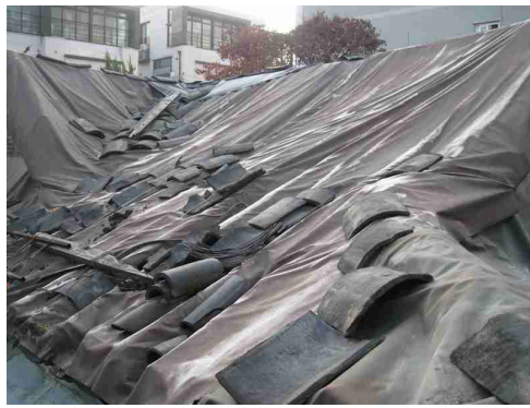
사진 12. 안채지붕 현황-2(보수 전)
