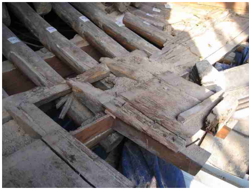
사진 31. 부연 손상 현황
